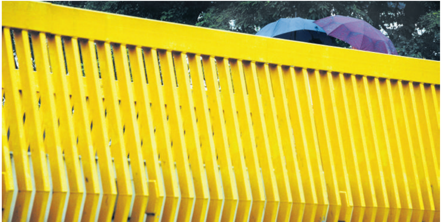
Stilsicher, aber nicht mehr wirklich sicher für die Benutzer: Stege des Nordwestzentrums.
